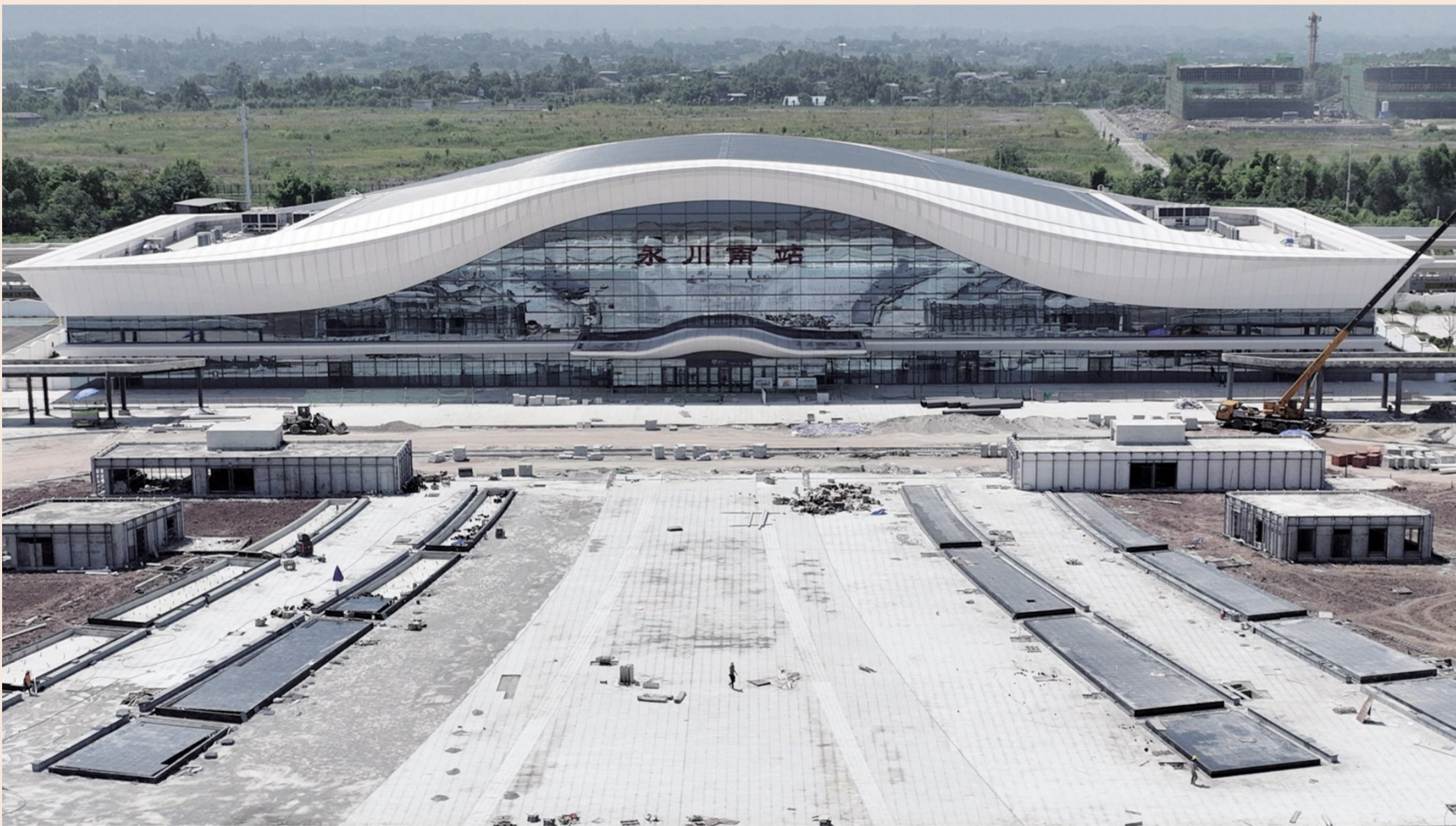
渝昆高铁永川南站综合交通枢纽及配套基础设施项目进展顺利
