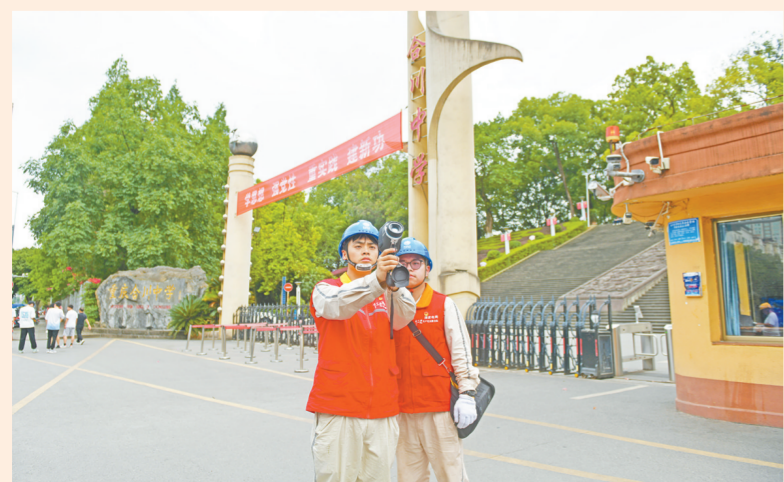
合川供电公司员工对合川中学2号专配室进行超声波局放检测 合川供电公司供图
