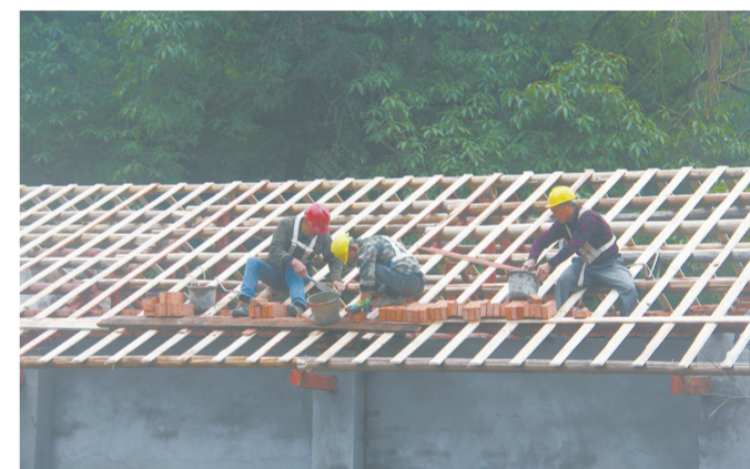
云门街道大碑村天星传统村落保护发展项目正有序推进，预计今年4月底前竣工。该项目计划投资1027.2万元，将围绕改造保护安居型传统民居、整治风貌不协调建筑等方面实施。图为施工队对大碑村天星传统村落部分传统民居屋顶进行修缮。
