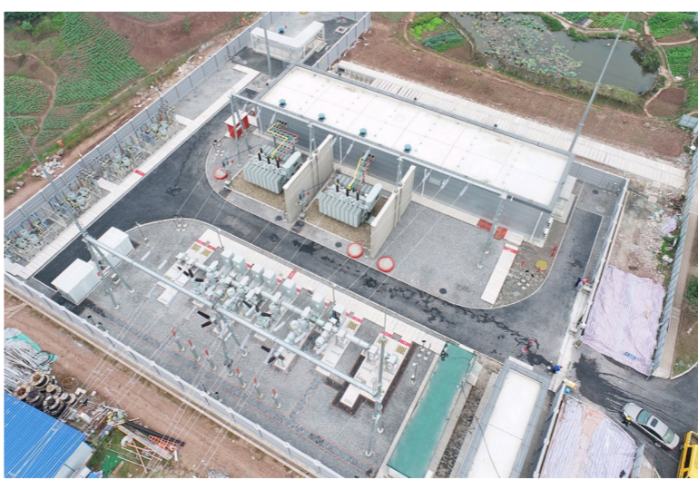
成功投运的110千伏五尊智能变电站
