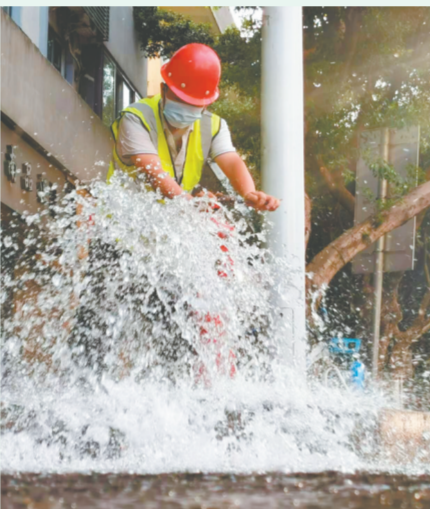
合川自来水公司员工查看消防栓水压情况 记者 周云 摄
