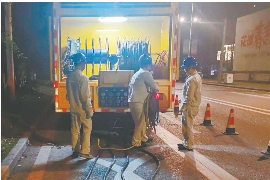
应急发电现场 合川供电公司供图
